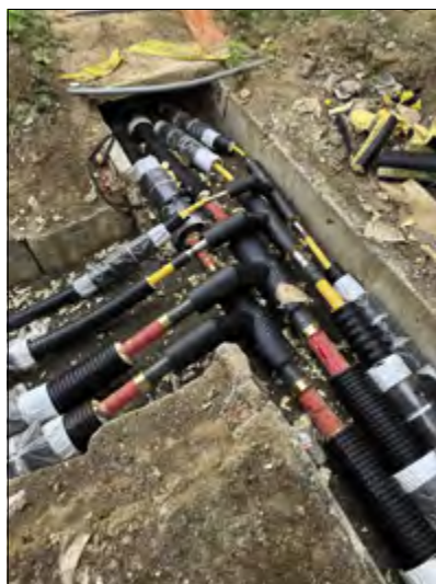
▲ Obr. 2 ● Realizace etážového T-kusu pro ústřední vytápění a rozvody teplé vody
