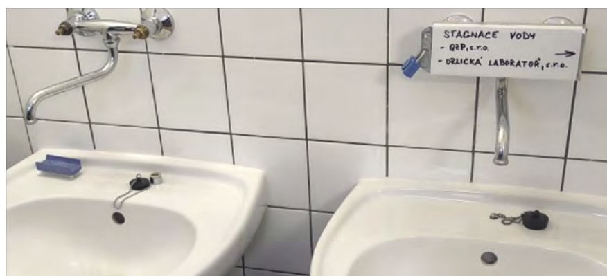
▼ Obr. 2 ● Obě připravené baterie na konci vnitřního vodovodu – vpravo bod A1
