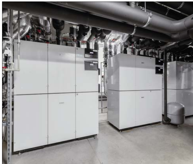
▲ Obr. 1 ● Tepelná čerpadla IVT s výkonem 450 kW pro vytápění a chlazení kasina
