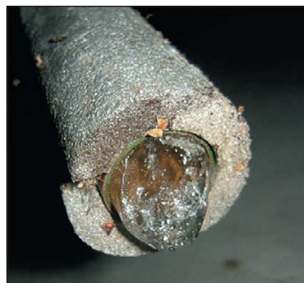
▲ Obr. ● Řez potrubím zamrzlým v celém průřezu
