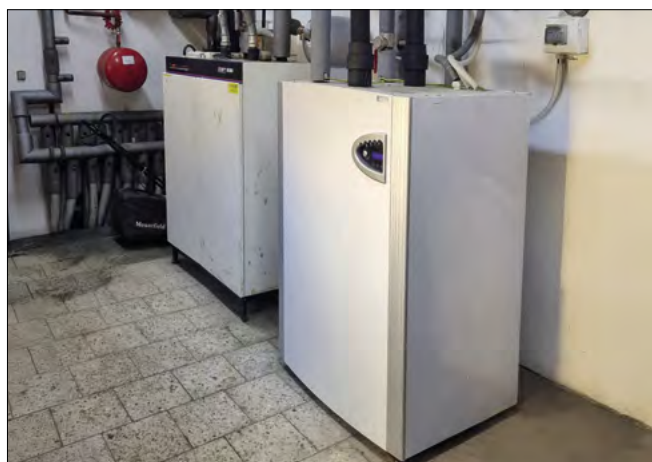
▲ Obr. 2 ● Stále funkční čerpadlo IVT s výkonem 65 kW z roku 1996
