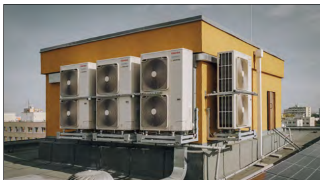
▲ Obr. 2 ● Tepelná čerpadla na střeše bytového domu od AC Heating
