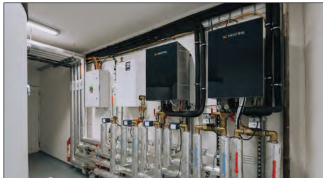
▲ Obr. 1 ● Kotelna s tepelnými čerpadly je stabilním řešením zdroje tepla
