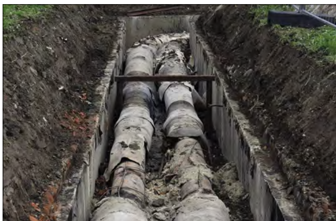
▲ Obr. 5 ● Původní stav ocelového potrubí v Humenném [4]
