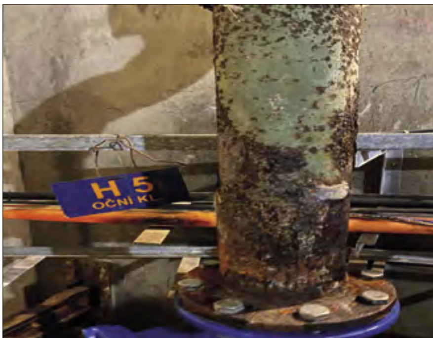
▲ Obr. 5 ● Místo s extrémní korozí, které přímo bije do očí i s adresou – odbočka na oční kliniku
