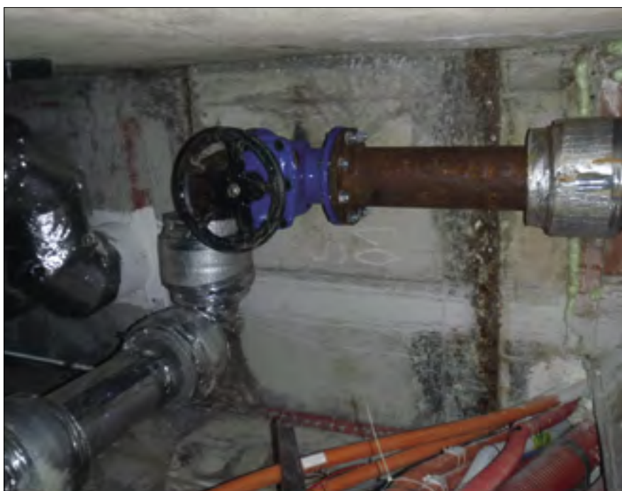
▲ Obr. 7 ● Detail zkorodovaného potrubí a nové uzavírací armatury – po montáži nové armatury nebylo provedeno odstranění koroze a natření novým nátěrem, chybí doplnění vhodné tepelné izolace
