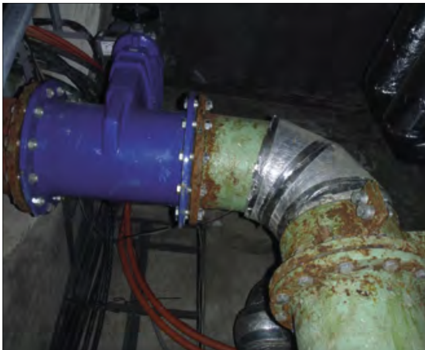
▲ Obr. 6 ● Pohled na nově vloženou uzavírací armaturu do povrchově silně zkorodovaného stávajícího potrubí bez doplnění a opravy nátěru a původní izolace
