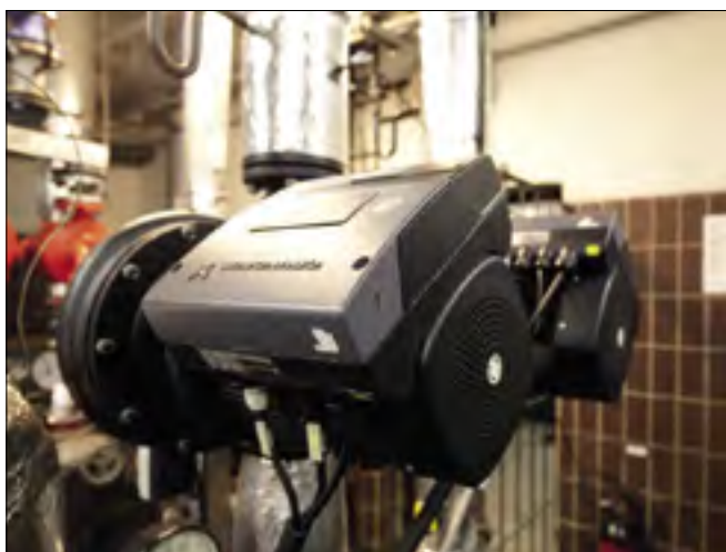
▼ Obr. 5 ● Oběhové čerpadlo Grundfos (původní čerpadla KSB byla postupně nahrazena modernějšími typy oběhových čerpadel)
