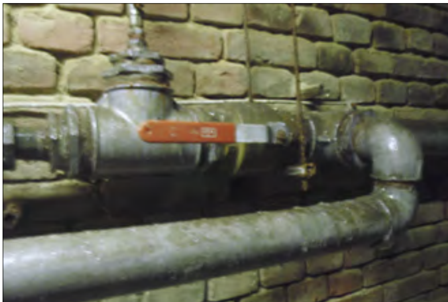
▲ Obr. 2 ● Pohled na výraznou povrchovou kondenzaci na neizolovaném potrubí studené vody
