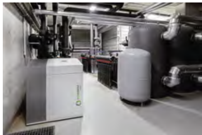
▲ Obr. 2 ● Zemní tepelné čerpadlo ecoGEO s výkonem 100 kW pro vytápění a chlazení bytového domu
