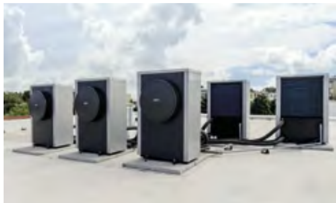
▲ Obr. 1 ● Bytový dům s tepelným čerpadlem IVT AIR X pro každý byt
