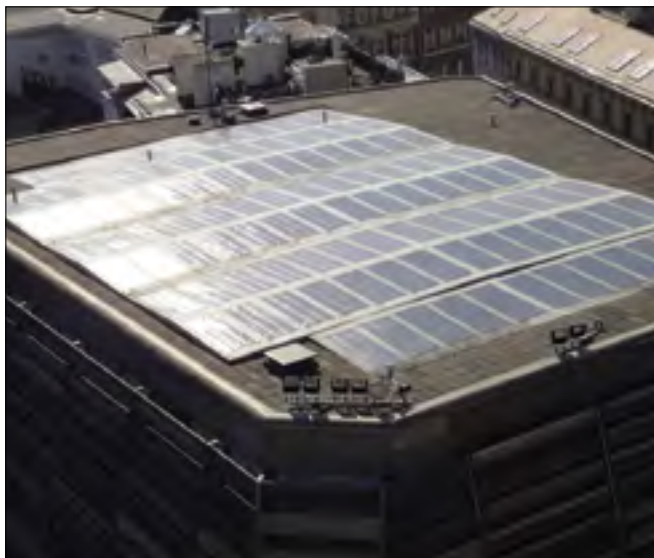
▲ Obr. 1 ● Fotovoltaické panely na střeše provozní budovy [1]
