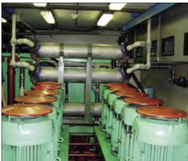
▲ Obr. 3 ● Ve strojovně hydrauliky jevištní technologie vzniká při ochlazování oleje velké množství odpadního tepla, které bylo dříve bez užitku odváděno s chladicí pitnou vodou do kanalizace, nyní se využívá k přípravě teplé vody [1]
