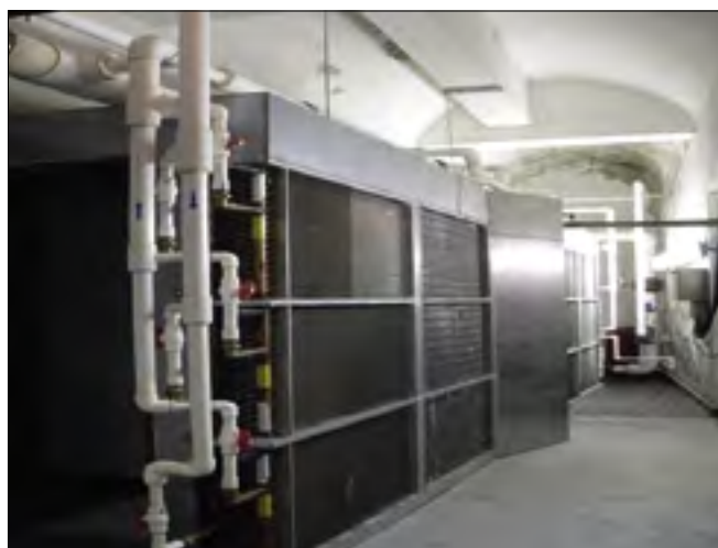
▲ Obr. 4 ● Tepelný výměník vzduch/glykolová směs na vstupu venkovního vzduchu do objektu. Bílé potrubí v přední části je přípojovací část mezikruhu s nemrznoucí kapalinou [1]
