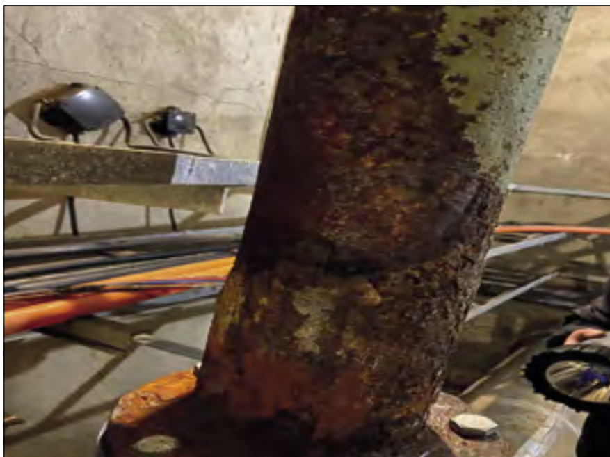
▲ Obr. 4 ● Abnormálně silná povrchová korozí potrubí hrozící vážnou poruchou a havárií celého vodovodního řadu se zatopením kolektoru vodou – ohrožení fungování nemocnice nebo minimálně její části s očekávanými velkými provozními a materiálními škodami
