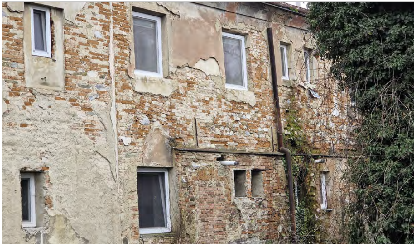
▲ Obr. 2 ● Vývod spalin v rozporu s předpisy – příklad z praxe
