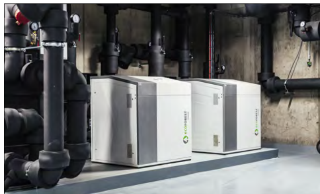
▲ Obr. 1 ● ECOFOREST HP pro vytápění a chlazení bytového domu
