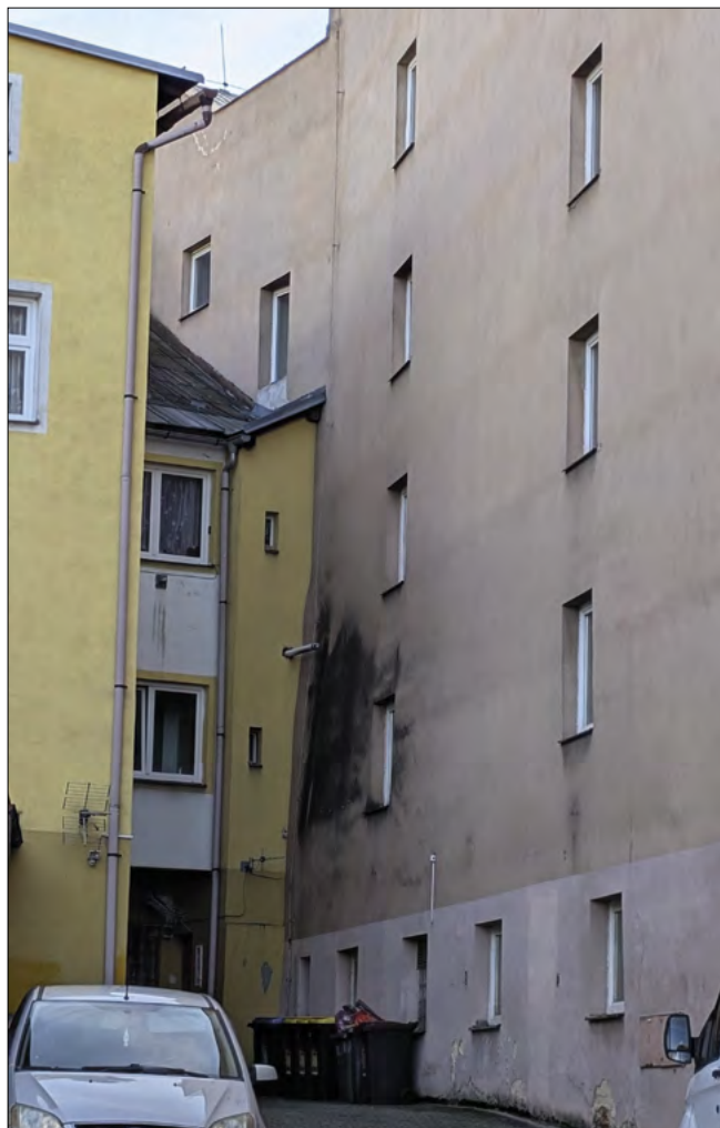
▲ Obr. 1 ● Vývod spalin v rozporu s předpisy – příklad z praxe
