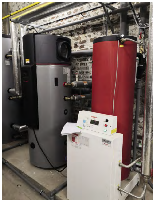
▲ Obr. 6 ● Instalace tepelného čerpadla pro předehřev teplé vody v ZŠ Křesomyslova
