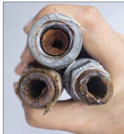
▲ Obr. 1 ● Inkrustace a koroze ve vnitřním průřezu pozinkovaných fitinek z temperované litiny [6]
