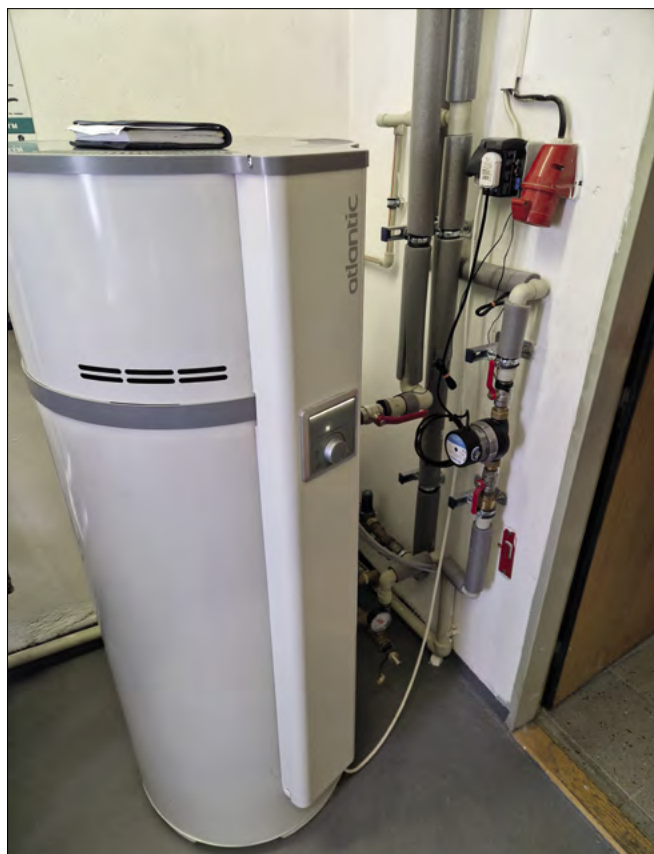
▲ Obr. 5 ● Instalace samostatného tepelného čerpadla pro přípravu teplé vody
