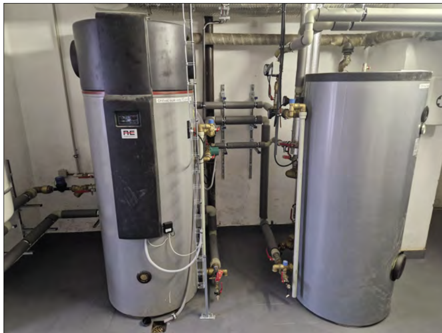
▲ Obr. 4 ● Zásobníky teplé vody, kdy tepelné čerpadlo je zapojeno jako předehřev teplé vody v bytovém domě
