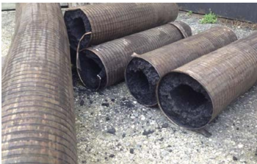
▼ Obr. 15 ● Zanesená komínová vložka
