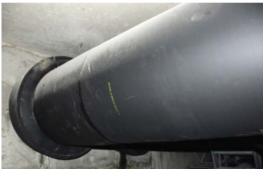
▲ Obr. 15 ● Pohled na zaizolovaný přívod pitné vody do objektu s využitím vhodné izolace ze syntetického kaučuku
