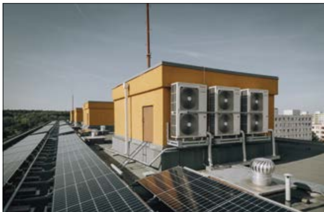
▲ Obr. 3 ● Firma AC Heating pomohla s úsporným vytápěním už 137 bytovým domům
