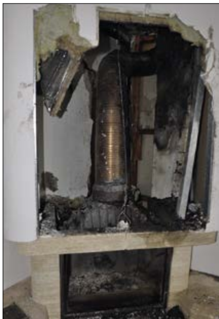
▲ Obr. 6 ● Neodborně provedená krbová obestavba
