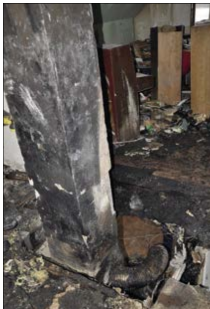
▲ Obr. 7 ● Neodborně realizované napojení kouřovodu do komínu v úrovni hořlavé stropní konstrukce
