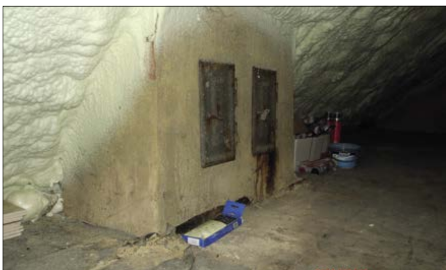
▲ Obr. 4 ● Hořlavý tepelný izolant v přímém kontaktu s komínem
