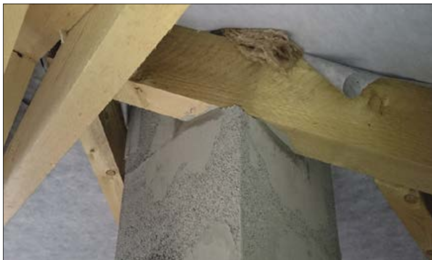
▲ Obr. 1 ● Trám zazděný do komínového systému
